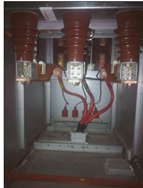
Gambar 5. Bagian Dalam Cable Compartment MV Switchgear
