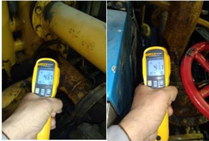
Gambar 8 Temperatur Sebelum dan Sesudah Heat Exchanger
