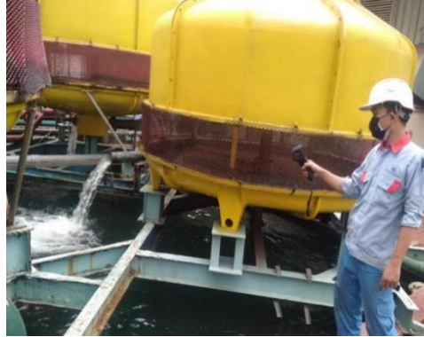
Gambar 3.3 Pengecekan suhu air pada cooling tower
