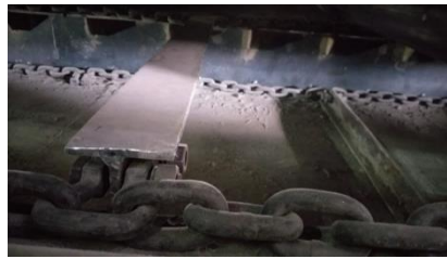
Gambar 4. Tampak dalam spillage conveyor
