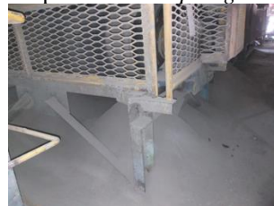
Gambar 6. Area sebelum adanya spillage conveyor
